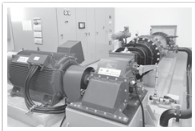
【陣内森林公園小水力発電所（長野県立科町）】
